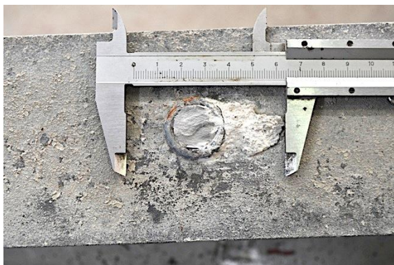
e) Detalle perno tras rotura
