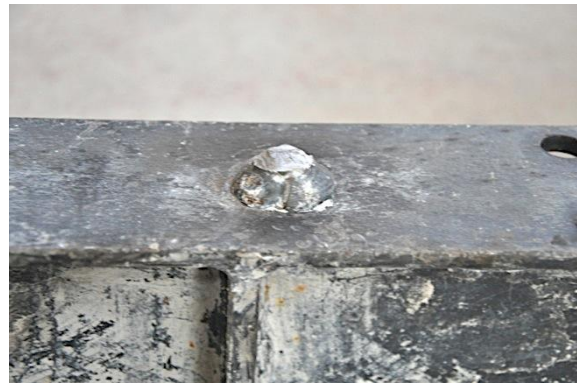
e) Detalle perno tras rotura
