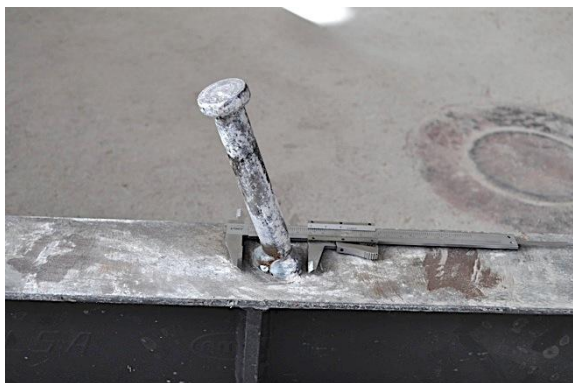
e) Detalle perno tras rotura
