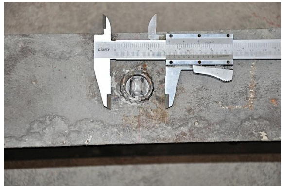
f) Detalle perno derecho tras rotura
