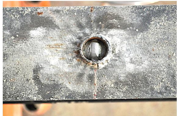
f) Detalle perno derecho tras rotura
